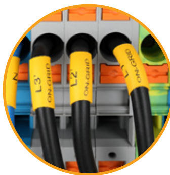
SPECJALNE OZNACZENIA PRZEWODÓW ROZDZIELNIC SZR
